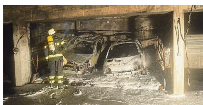
Ein Bild der Verwüstung: Die Autos sind komplett zerstört, die Decke ist stark beschädigt Fotos: Feuerwehr, Networkpictures
