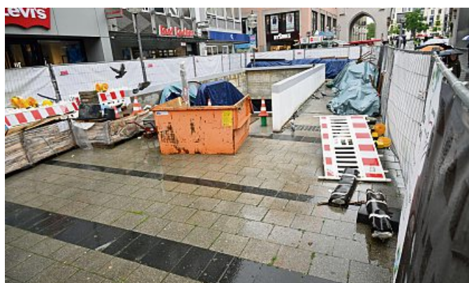
So schaut die Dauer-Rolltreppenbaustelle in der Neuhauser Straße aus - und nicht erst seit gestern....
